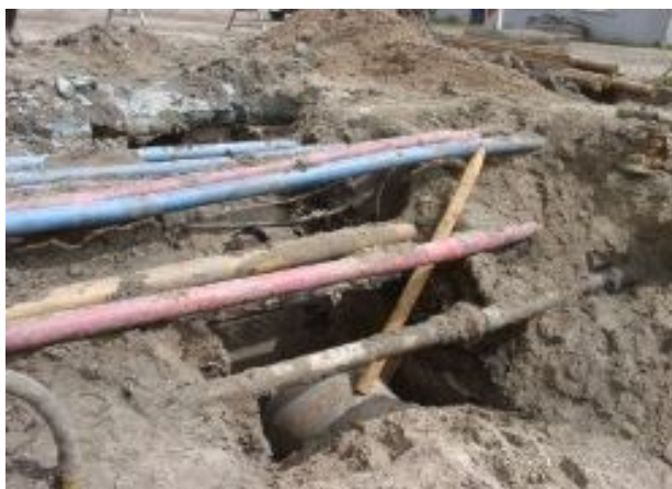
Kabels en leidingen
