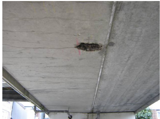
Overzicht gescheurd prefab element met uitgehakt deel
