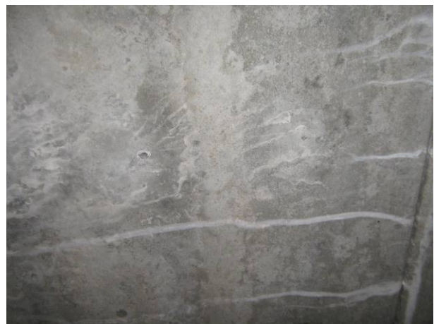
Foto 4: Boorgaten in holle kanaalplaten met vochtuittreiding
