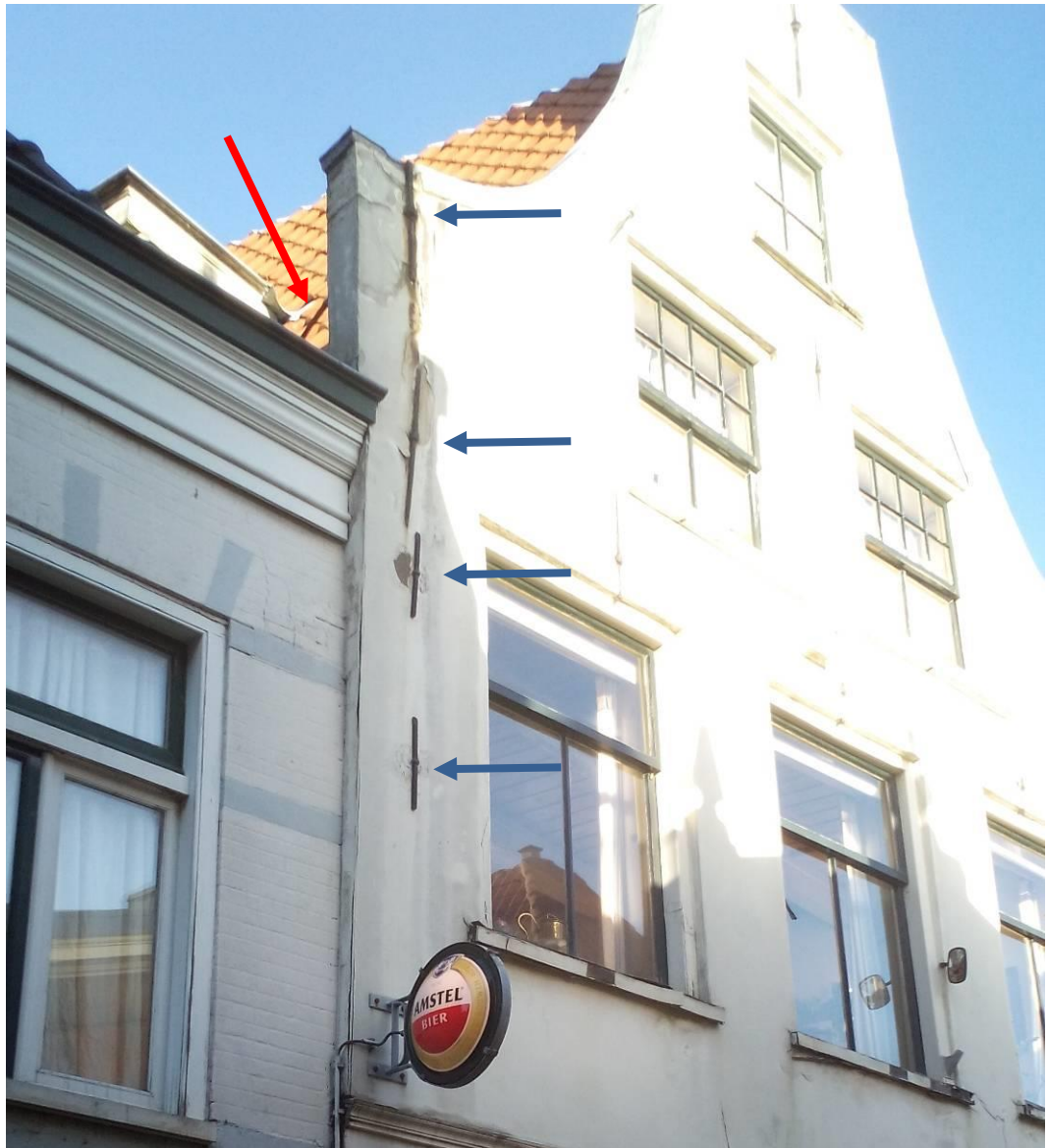
Afbeelding 5 - detail voorgevel - de voorgevel lijkt met muurankers (blauwe pijlen) vast te zitten aan de achterbouw; het bovenste muuranker is via een stang (rode pijl) aan de achterbouw verankerd.
