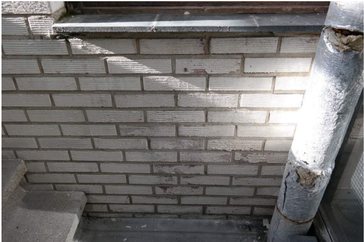
In het achterste trappenhuis zijn de originele witte bakstenen nog niet geschilderd. Ook hier begint de toplaag echter los te komen. Mogelijk was dat de reden om de muren in het voorste trappenhuis geheel wit te schilderen.
