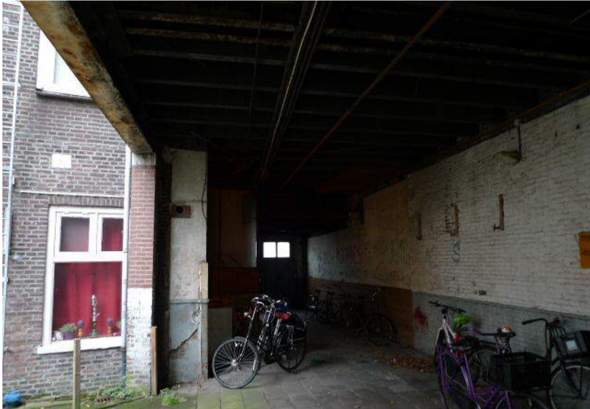
De onderzijde van de 1 e verdiepingvloer met lichte roestvorming op de stalen balken.
