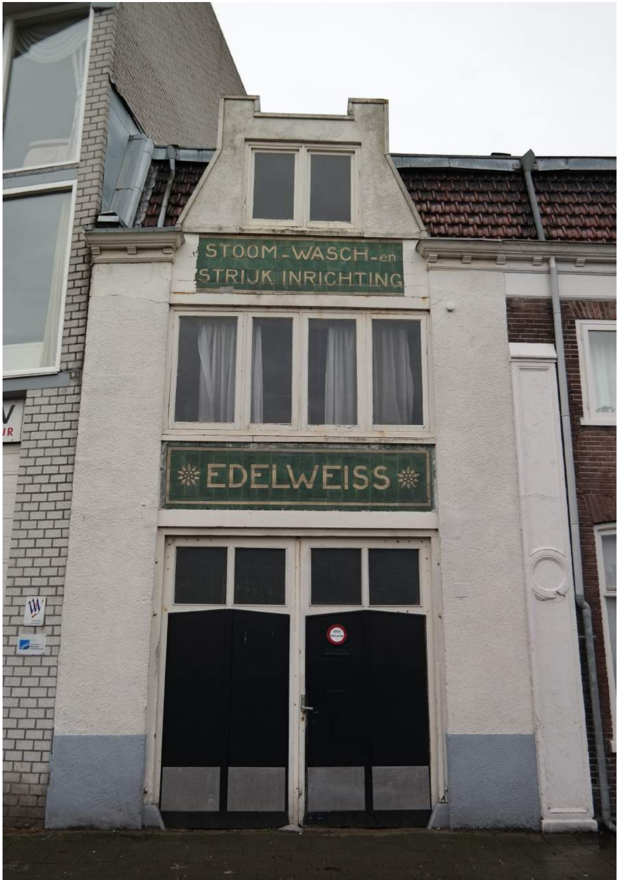
Voorgevel van nummer 30 met diverse zichtbare schades.
