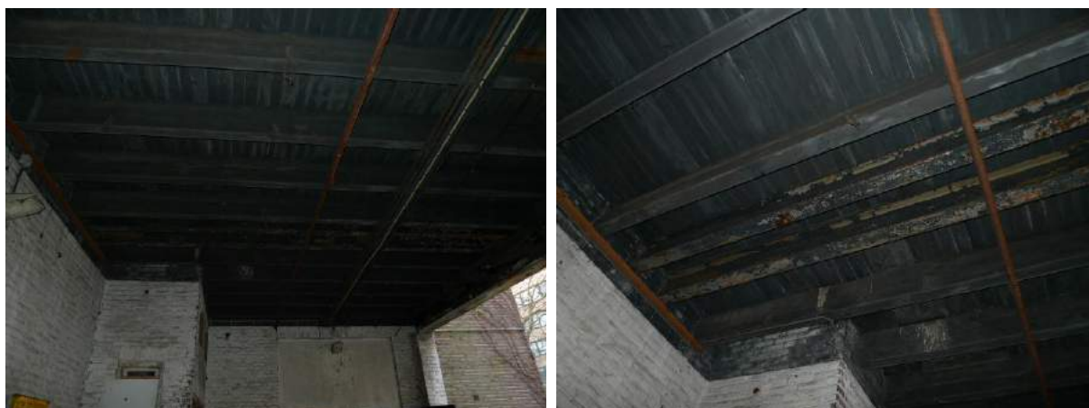
De verdiepingvloer van het brugdeel tussen het wasserijgebouw en het bouwdeel van 1881.
