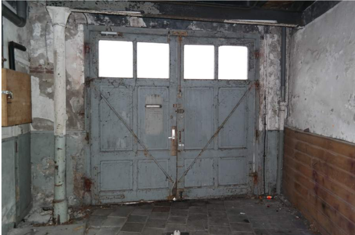
Entreegevel vanaf de binnenzijde. Linksonder is de verzakking in de vloer goed te zien.
