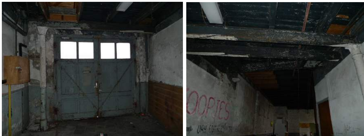
Begane grond met de poort in de voorgevel (links) en de doorloop naar het achterterrein (rechts).
