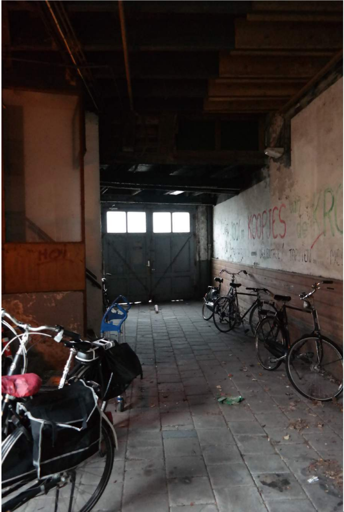
Doorgang gezien vanaf het binnenterrein richting de straat. De verspringing in de verdiepingsvloer geeft de overgang tussen het deel uit 1881 en het deel uit 1921 aan. Rechts zijn de vernieuwde balkkoppen te zien.
