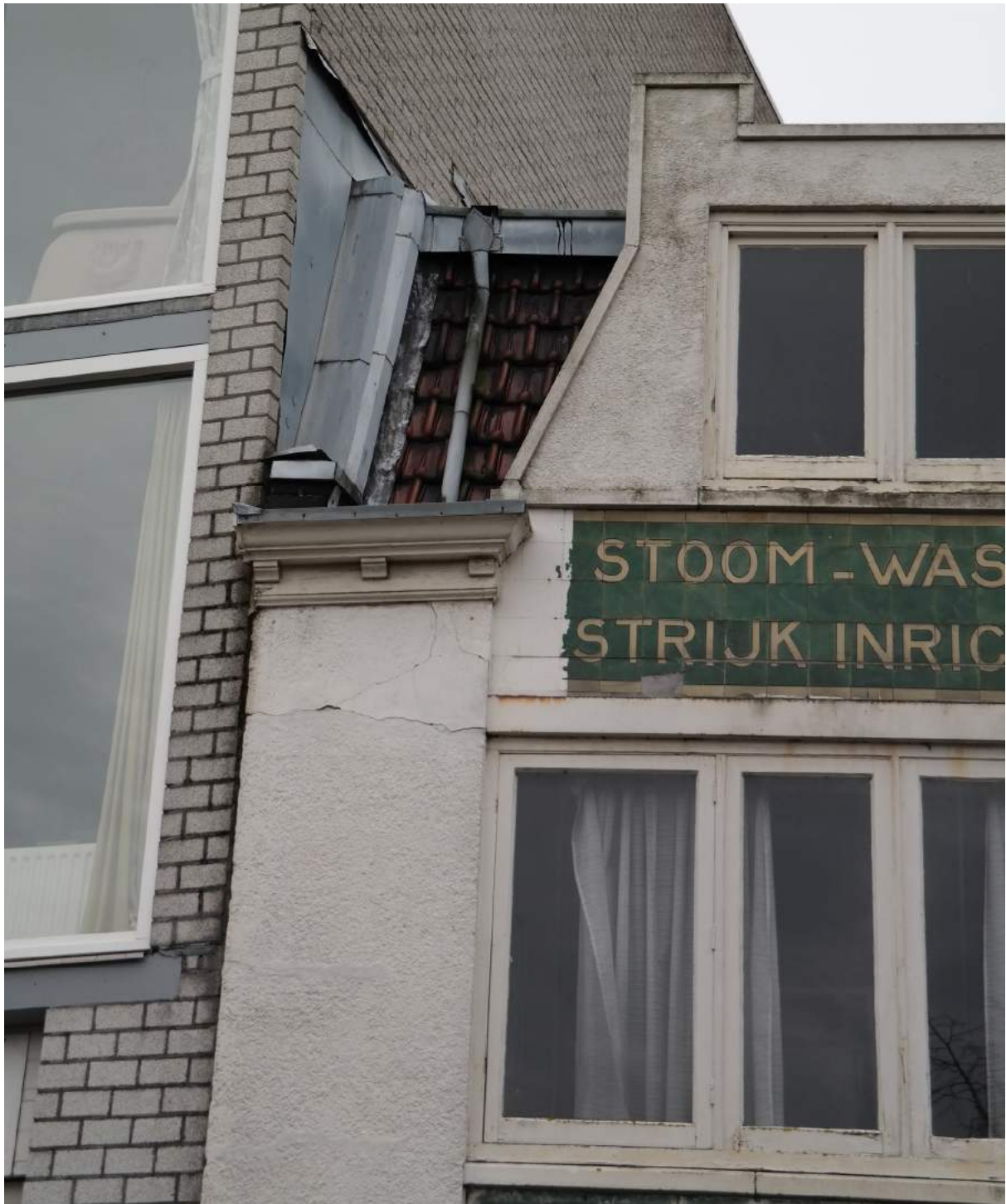
Detail van de voorgevel met de scheur en loskomend pleisterwerk. Ook is de vorstschade aan het tegeltableau te zien. De bruine vlekken duiden op roestvorming op de latei of door roestende schroeven in het kozijn.
