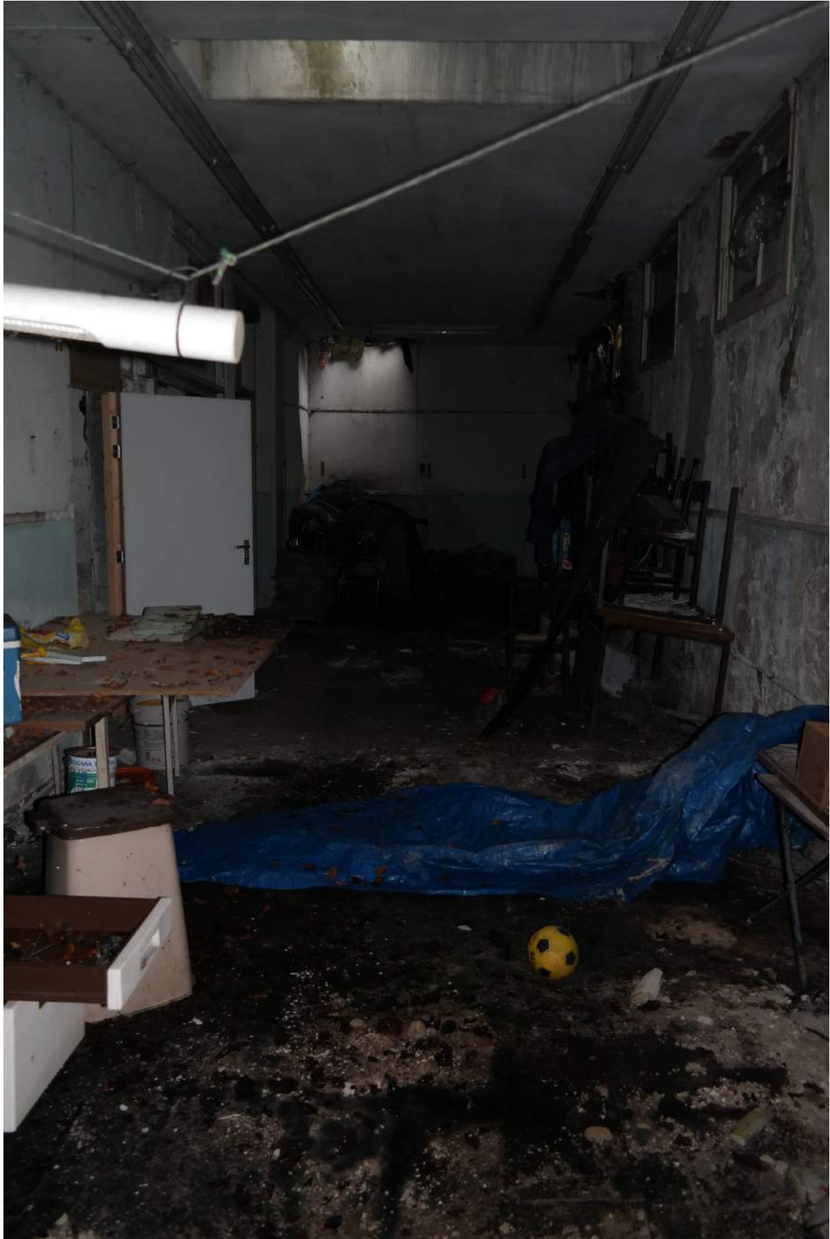
Interieur van het oude ketelhuis
