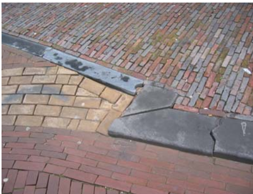
Foto 3.2.1.: Voorbeeld gebrekkige detaillering: Rivierischmarkt
