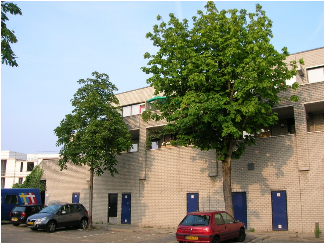
De kastanjes 6 en 7 staan dicht tegen de gevel. Beide zijn ernstig aangetast door de kastanjabloedingsziekte.
