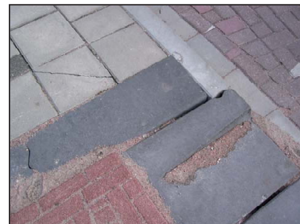
Foto 3.2.1: Voorbeeld gebrekkige detaillering: Meerwijk Centrum
