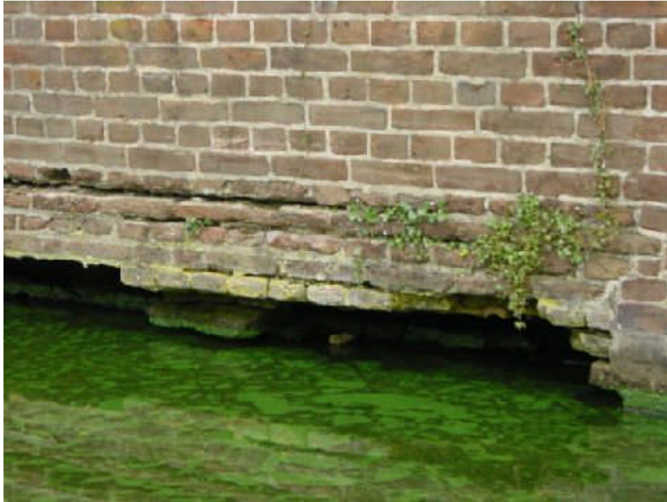
Foto 4: Nieuwe gracht: afbrokkelende kademuur, op termijn instortingsgevaar
