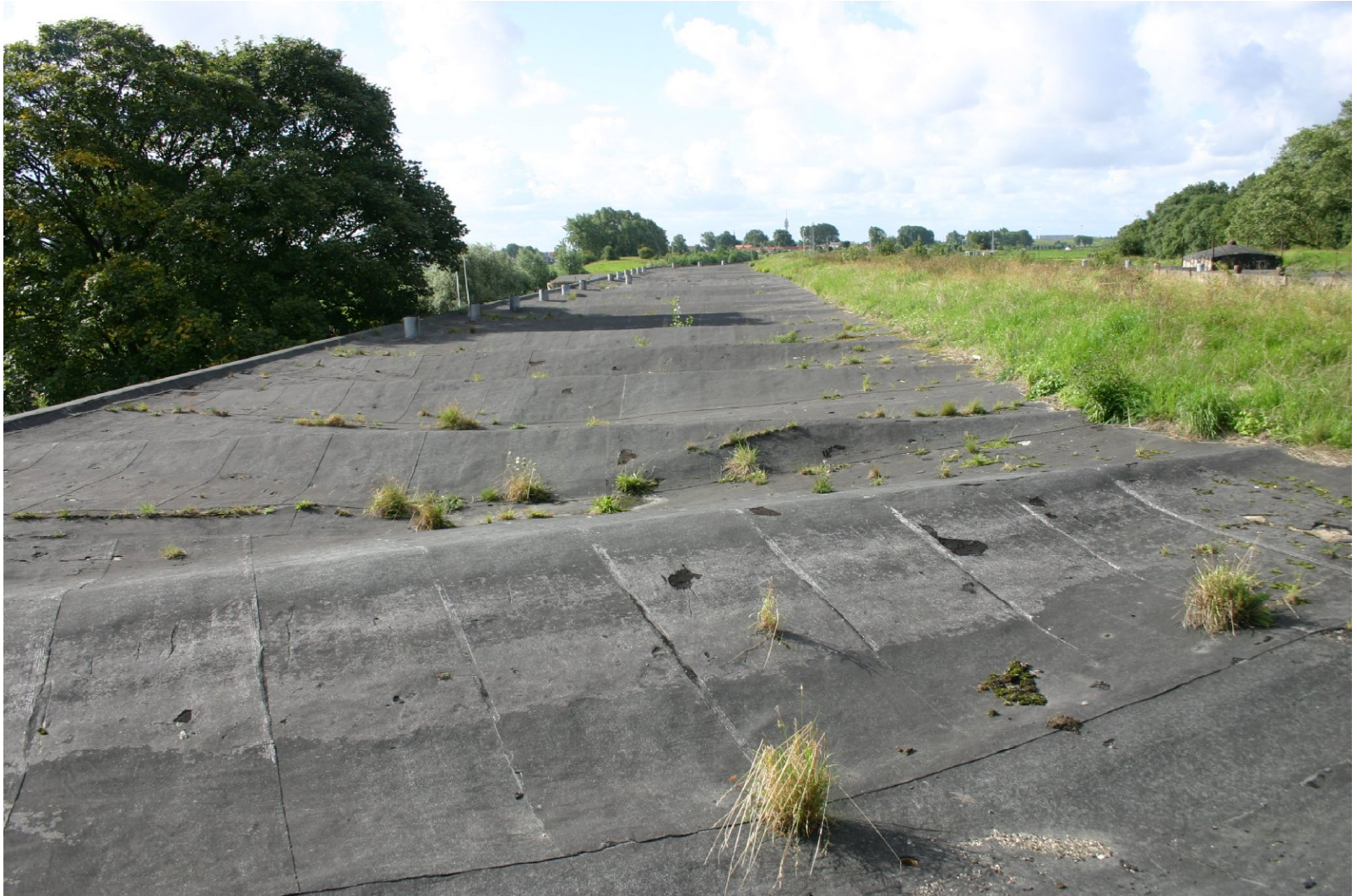
Figuur 5: De hoogste prioriteit ligt bij het waterdicht maken van het dak
