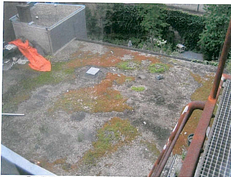
Foto C: Zicht op bestaand plat dak en op tuin belendende perceel in bestaande situatie
