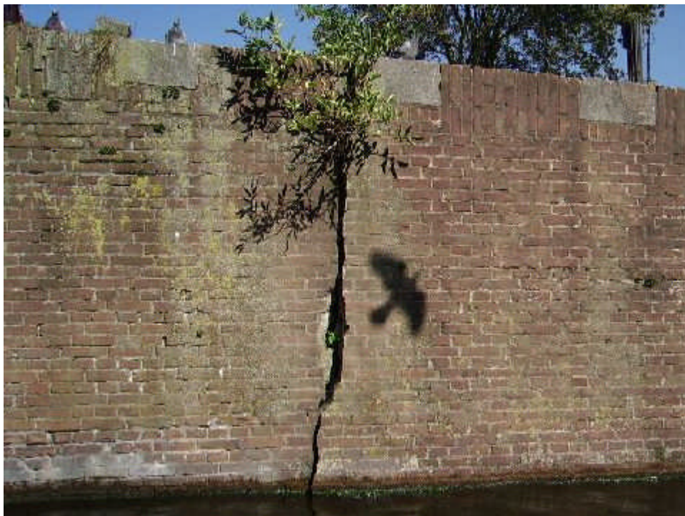
Foto 6: Raamsingel: gescheurde kademuur
