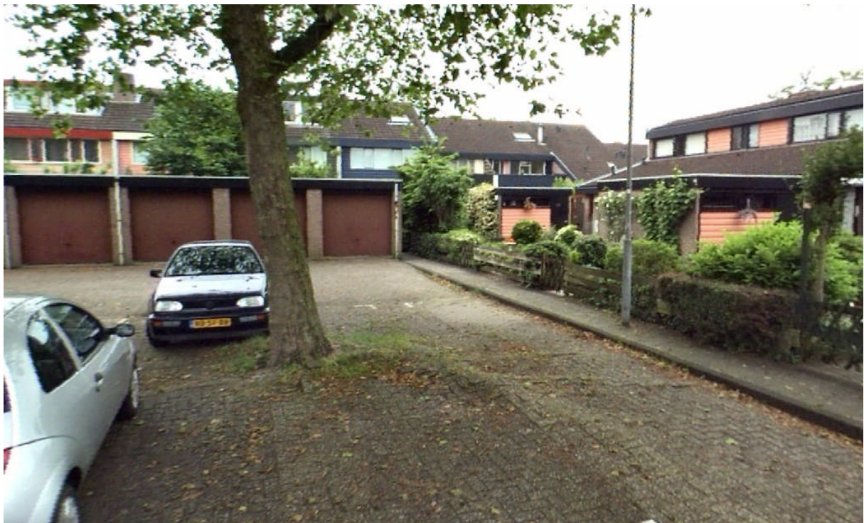
Foto 2: Sloeweg: inklinkende bodem, opdrukkende boomwortels
