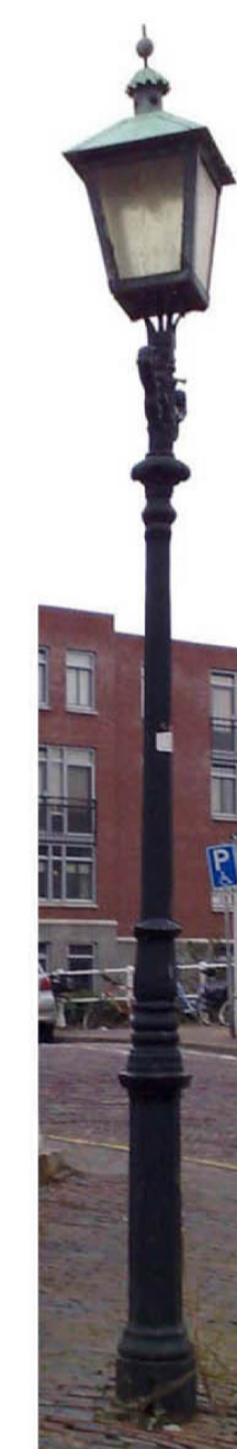
lichtmast met armatuur
