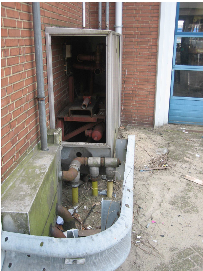
Foto 2: Leidingen aan oostzijde werkplaats
