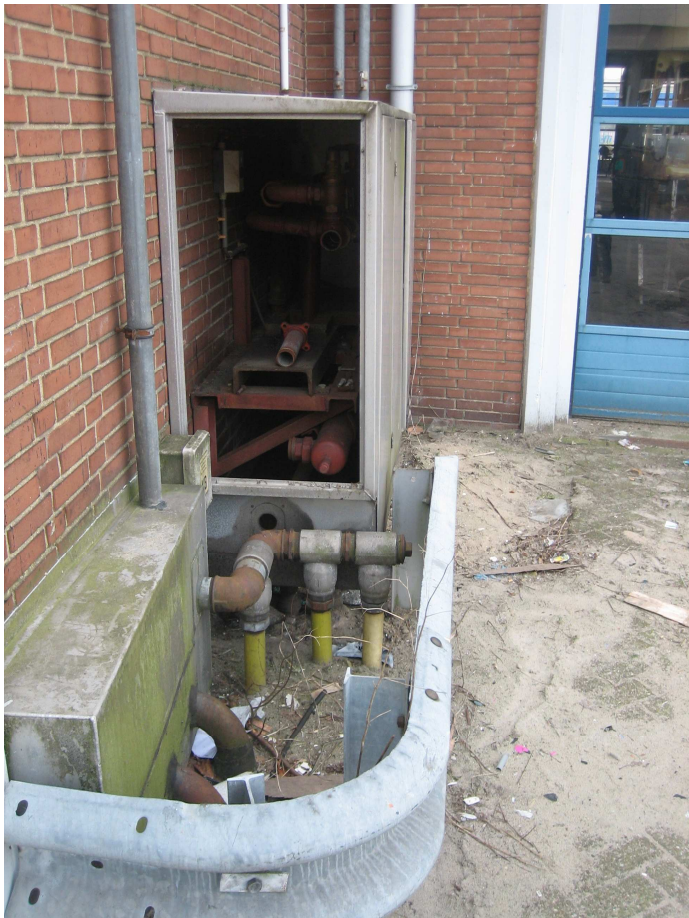
Foto 2: Leidingen aan oostzijde werkplaats
