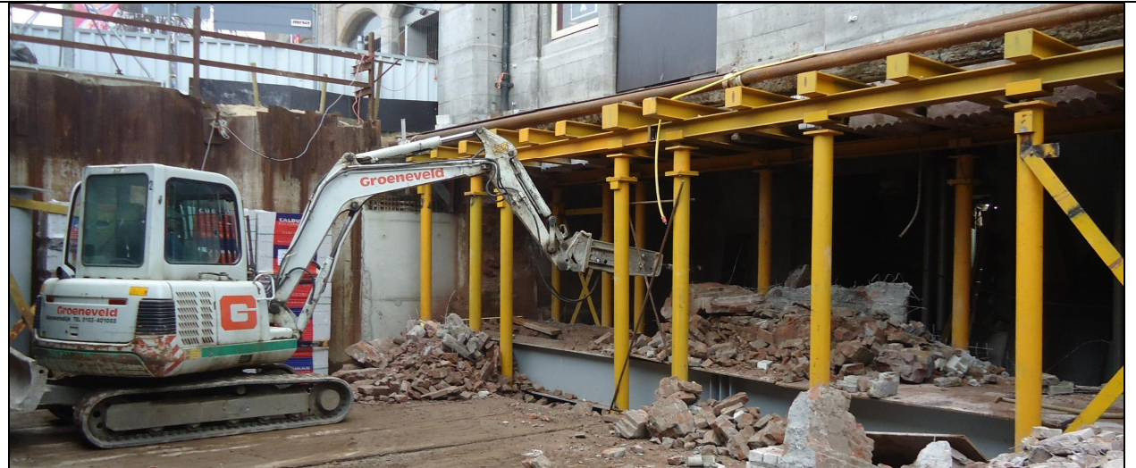
Figuur 7. Doorbraak ondergrondse gevelconstructie
