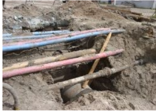
Kabels en leidingen
