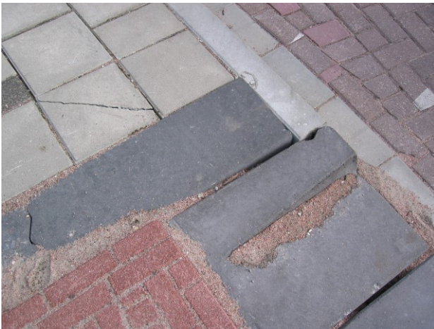
Foto 3.3.1: Voorbeeld gebrekkige detaillering: Meerwijk Centrum
