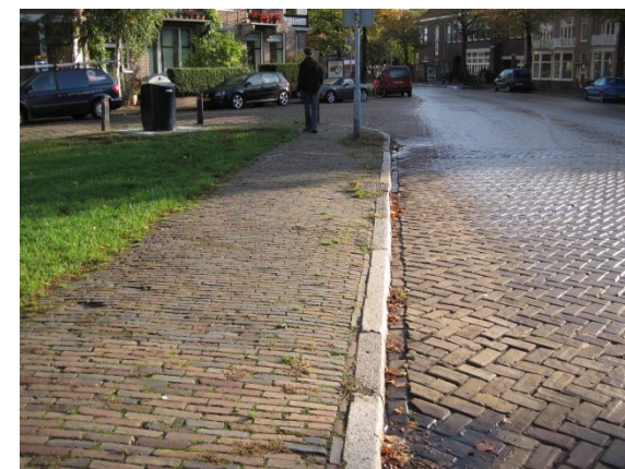
Foto 2.3.4.: Grote voorraad aan oude gebakken klinkers in verschillende formaten.
