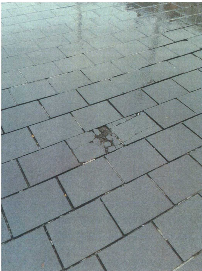
Afbeelding 4: losse en uitgebroken voegvulling en gescheurde elementen
