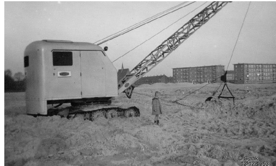
afb. 6 Foto uit 1953 genomen op het moment dat grondwerkzaamheden werden uitgevoerd ten behoeve van de bouw van de portiekwoningen aan de Hannie Schaftstraat. Op de achtergrond zijn de portiekflats aan de Richard Holkade en Henriëtte Bosmanstraat te zien (bron: www.haarlem-oost.nl ).
