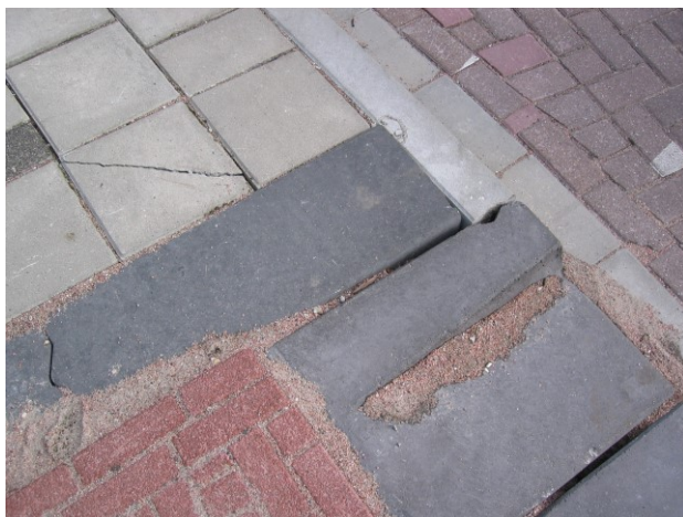
Foto 3.3.1: Voorbeeld gebrekkige detaillering: Meerwijk Centrum
