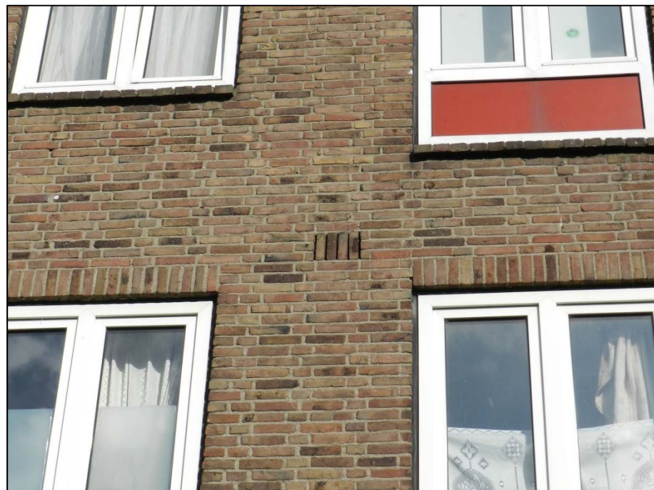
Openingen naar de spouwmuur waar een zomerverblijf van Gewone dwergvleermuis werd vastgesteld.
