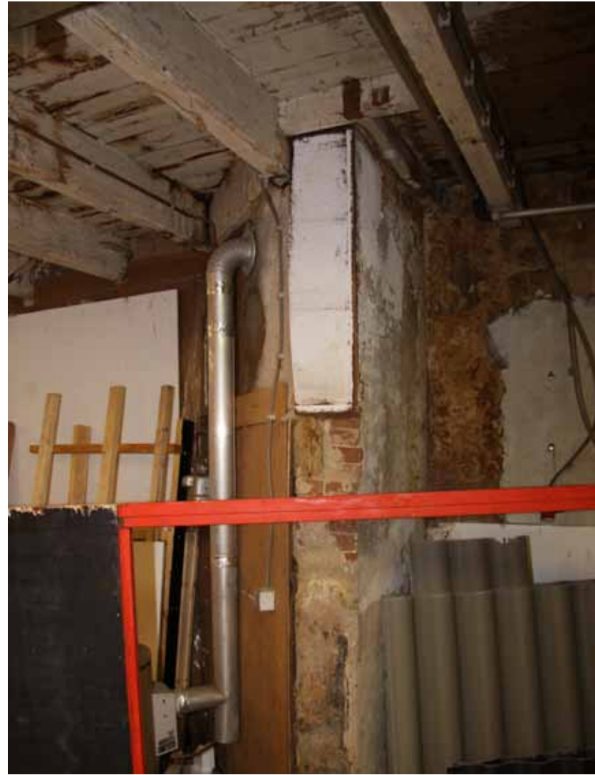
afb.20: restant muurwerk en schouw van de voormalige voorgevel van het oudere bouwdeel
