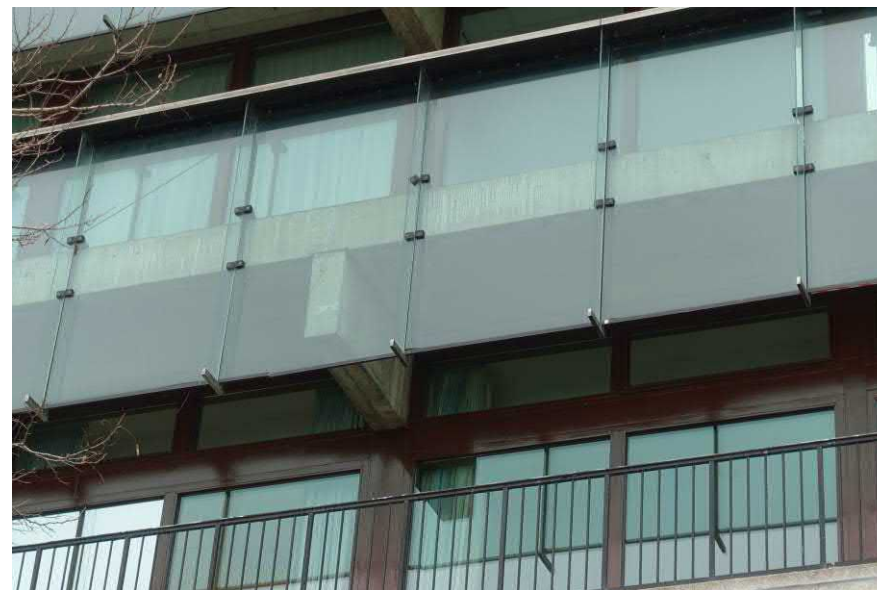
Detail van de balkon en balustradeconstructie met het zonwerende glas. FH MAB 2019
