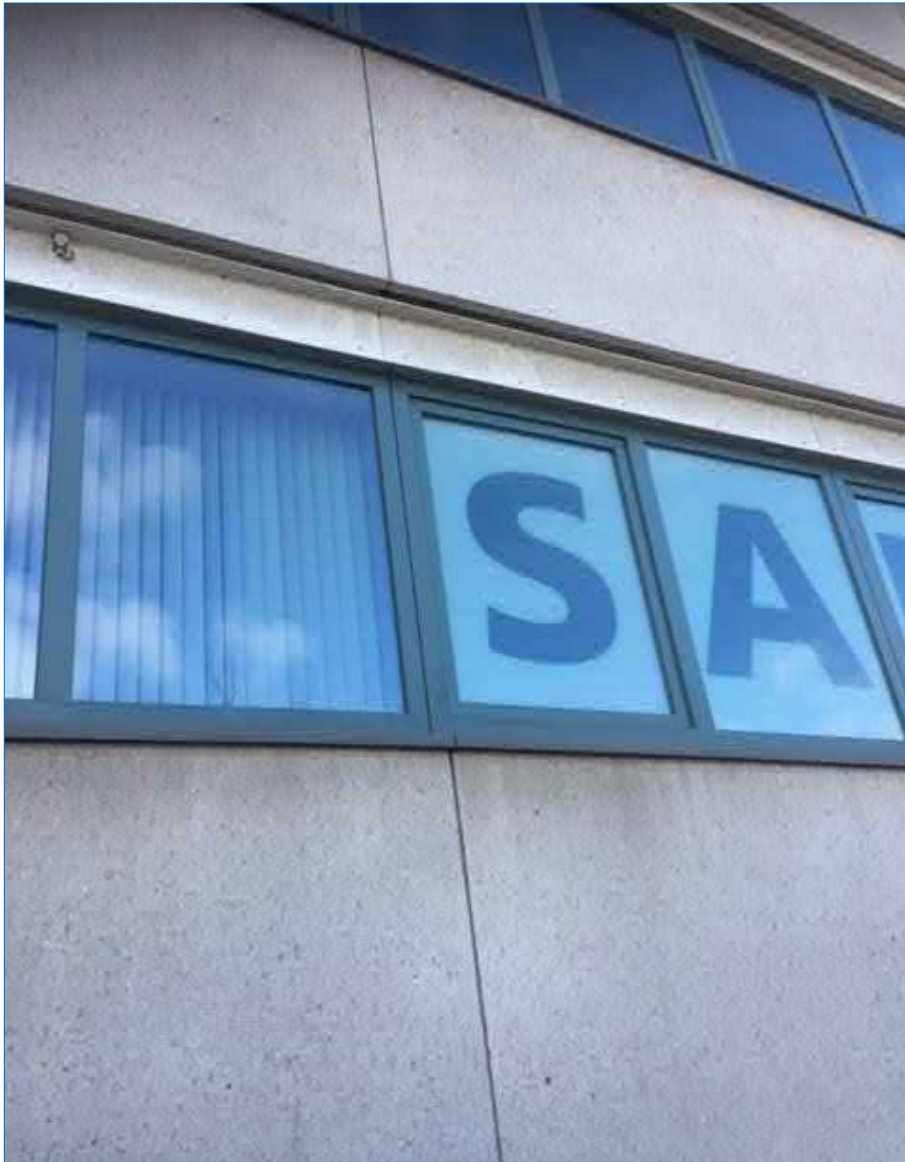
figuur 14: ruimte achter de gevelplaten, deze platen zijn ideaal voor vleermuizen en worden hier vaak aangetroffen
