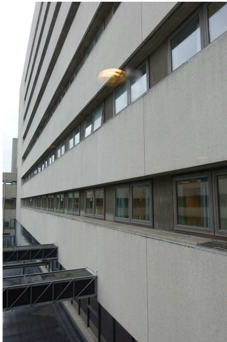
Gebouw 2 van het beddenhuis, zicht langs de noordgevel naar het oosten. FH MAB 2019
