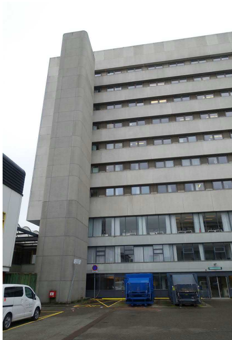
Gebouw 3 van het beddenhuis, zicht op de linker helft van de noordgevel vanuit de verdiept gelegen binnenplaats. De onderste laag is hier de kelder. FH MAB 2019
