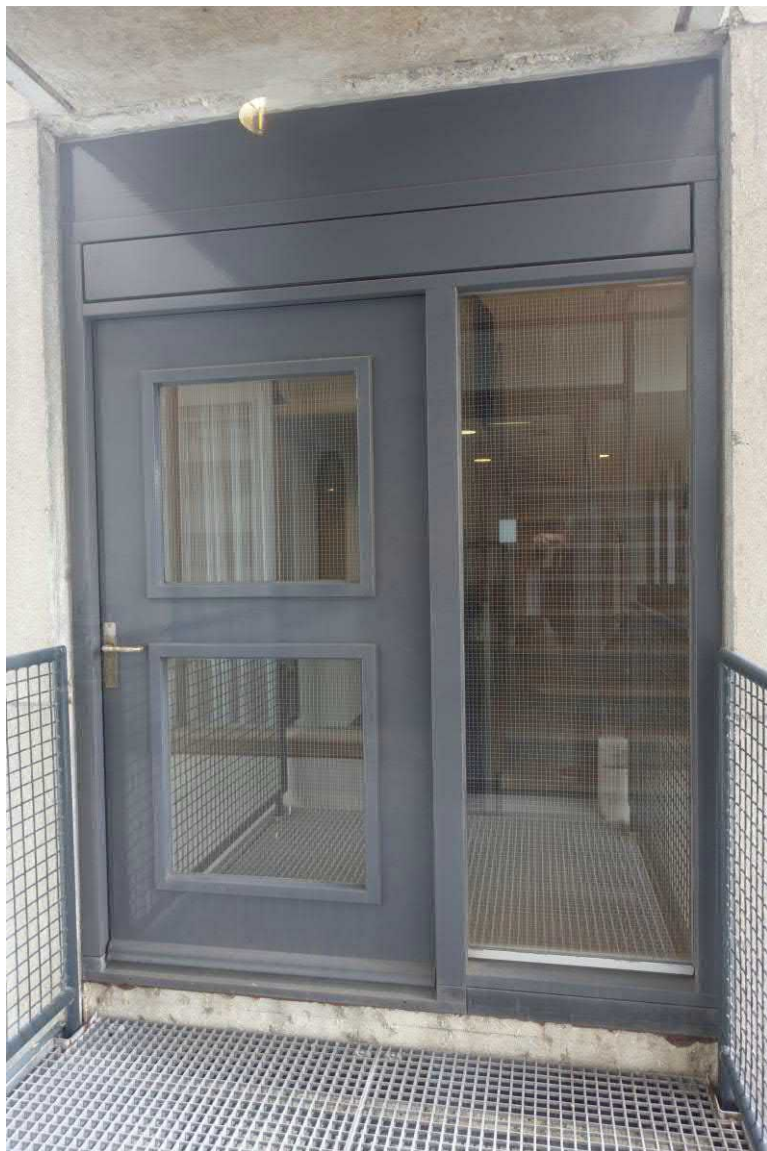
Een deur met zijlicht in de noodtrappentoren op de verdieping in gebouw 3 bij de kantoren van de Raad van Bestuur naar het noorden gezien. FH MAB 2019
