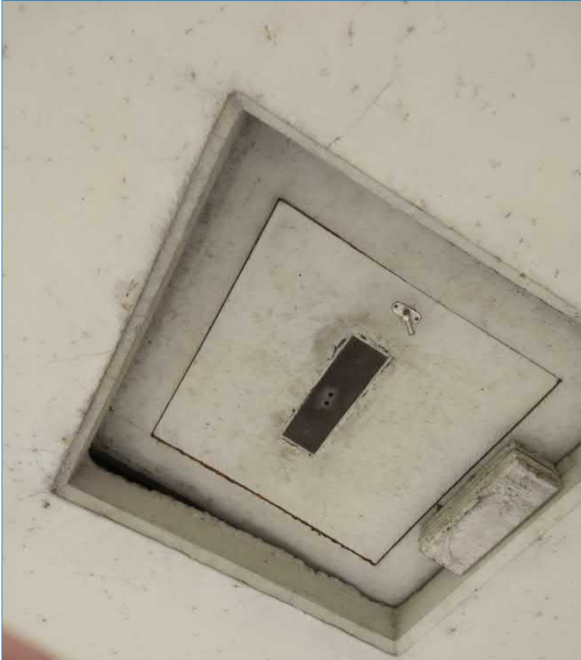
figuur 11: open luik onder gebouw aan de boerhavelaan 32
