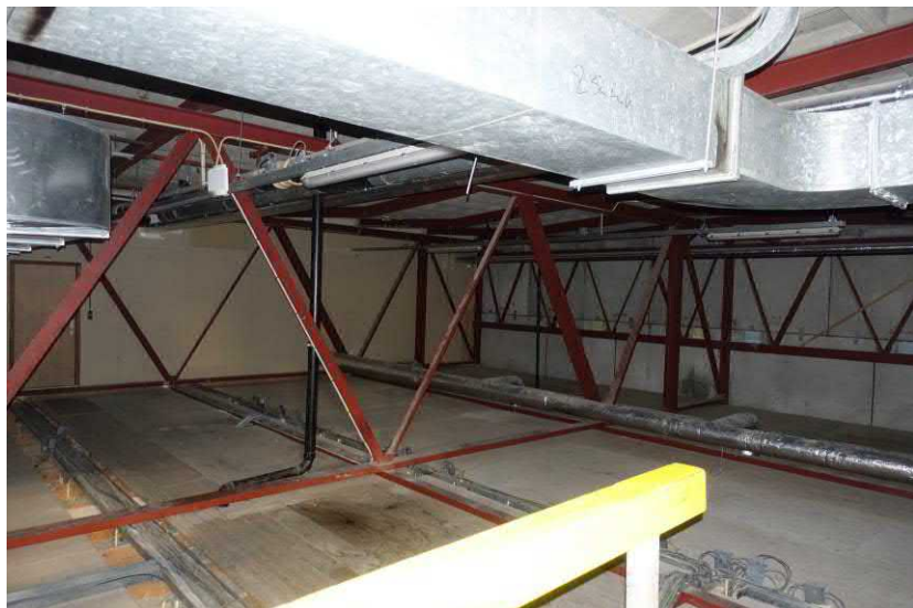
Een zolderruimte met stalen vakwerkliggers in gebouw 2 naar het zuidoosten gezien. FH MAB 2019
