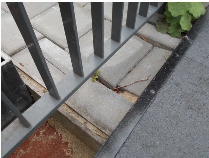
Foto 3: verzakking straatwerk door uitspoeling.
