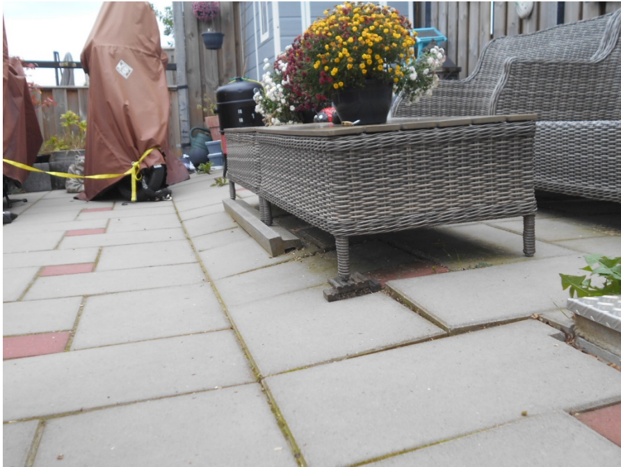
Foto 4: verzakking straatwerk door zetting van de ondergrond.
