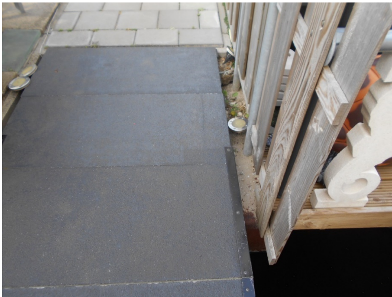
Foto 2: steiger ligt op damwand, straatwerk is niet goed opgesloten waardoor zand uitspoelt.
