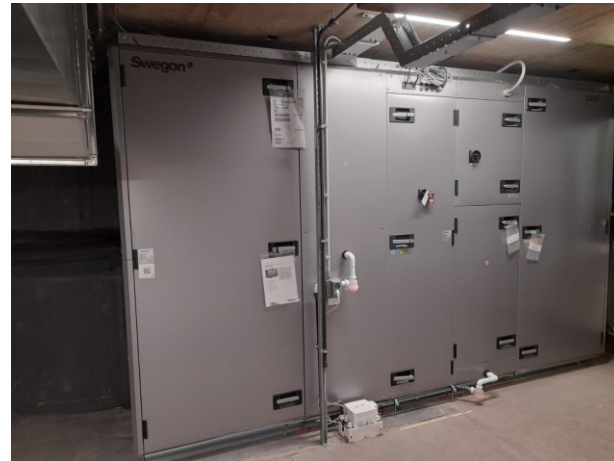
Nieuwe luchtbehandelingsinstallatie Nieuwbouw
