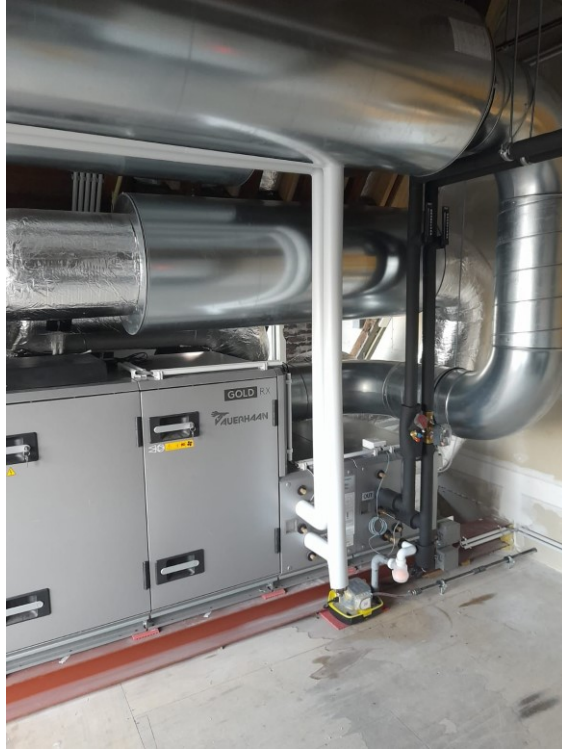
Nieuwe luchtbehandelingsinstallatie Rijksmonument
