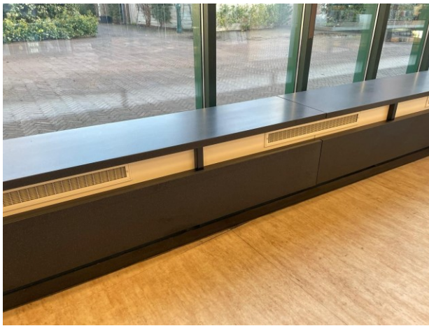
Nieuwe banken met geïntegreerde luchtbehandelingsinstallatie Nieuwbouw
