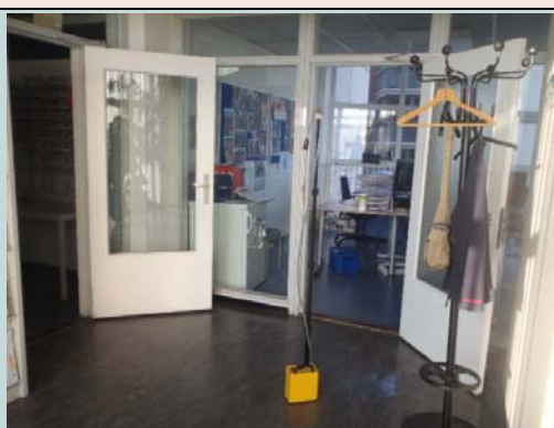
Pomp 10 in gang 3e Verdieping bij meterkast
