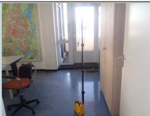
Pomp 12 in gang 3e Verdieping bij ruimte 306
