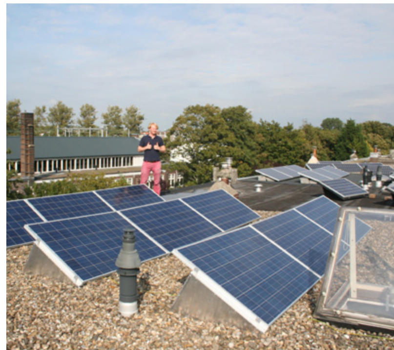
Zonnepanelen geplaatst op het dak van Duvenvoordestraat 66
