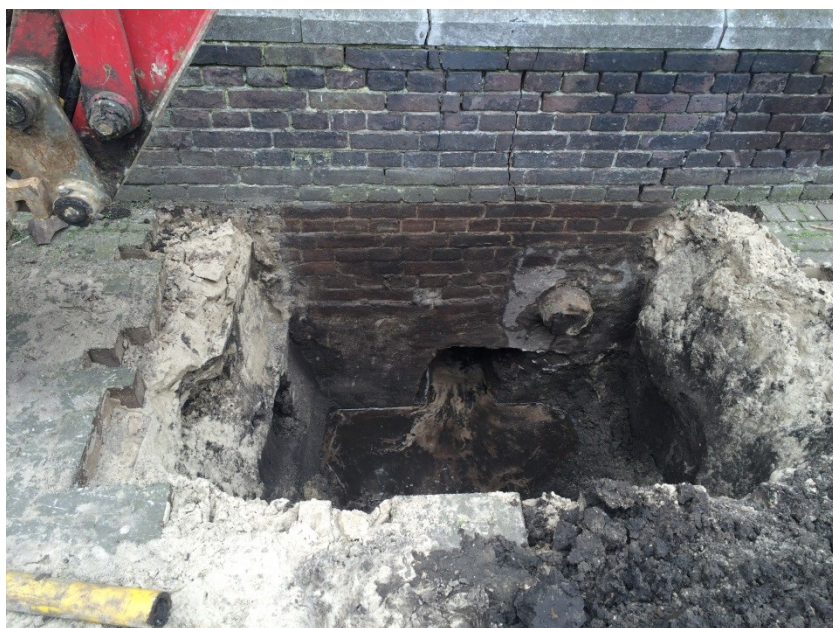
afb. boven/links: ter plaatse van de doorgaande scheurvorming in de oostgevel van het Energiehuis is onderzocht of deze een oorsprong heeft in de fundering. Na ontgraving is gebleken dat dit niet het geval is. Een andere mogelijke oorzaak wordt onderzocht.
