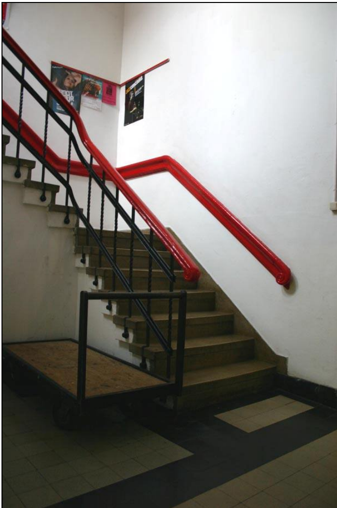
Afb. 44) De trap behorend bij de klassevleugel, maar gesitueerd aan de gang in de zustervleugel, gezien naar het noordoosten. Deze deels betonnen trap kan aan de hand van een bouwtekening in 1921 worden gedateerd (afb. 6). Bij die verbouwing werd op het oorspronkelijke platte dak van de klassevleugel een zolderverdieping gebouwd, die in 1976 is vervangen (afb. 18).
