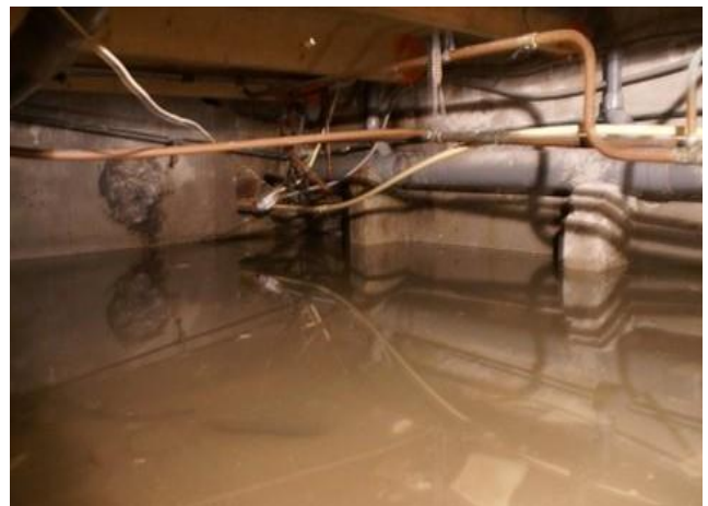
Figuur 2-1 Grondwater in kruipruimte (Bosch en Vaart)
