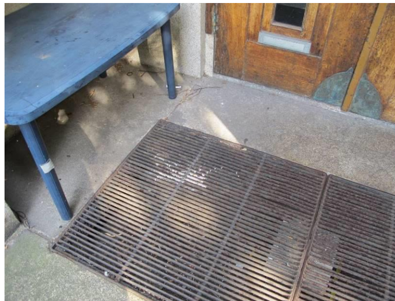
Oorspronkelijk schoonlooprooster in granieten vloer entreeportaal.
