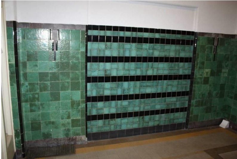
Tussen 1968 en 1972 dichtgemetselde doorgang in oostwand van de zuidelijke vestibule. De afwijkende tegels passen niet bij de omliggende afwerkingen.
