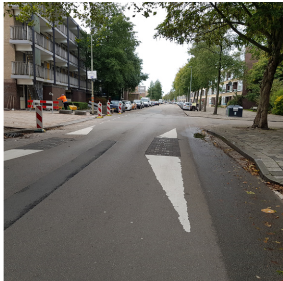
Asfalt kan teerhoudend zijn en daardoor een risico vormen.
