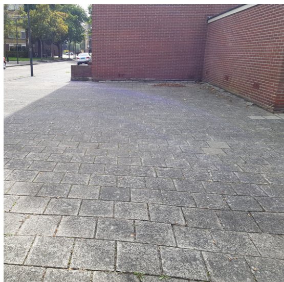
Overmaat aan onnodige verharding
