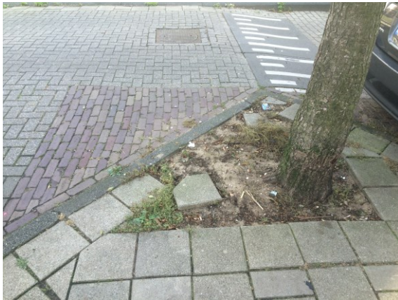
Afbeelding 3.3.2: Voorbeeld gebrekkige detaillering en ontbrekende samenhang in materialen
