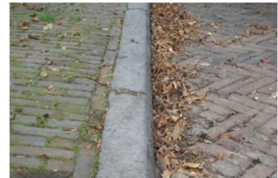
Afbeelding 5.2.9: klinkers in het trottoir
