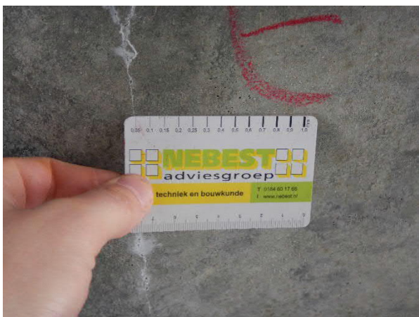
Figuur 7: Langsscheur ter plaatse van E6E
