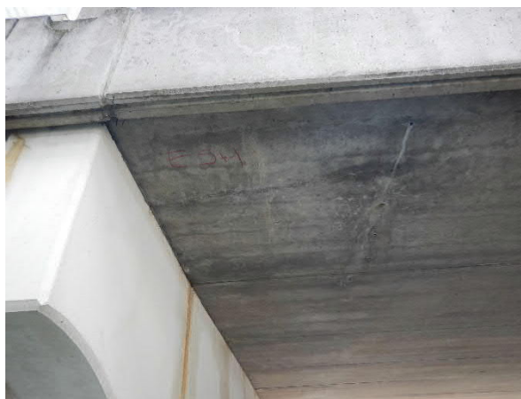
Figuur 8: Langsscheur ter plaatse van E9H
