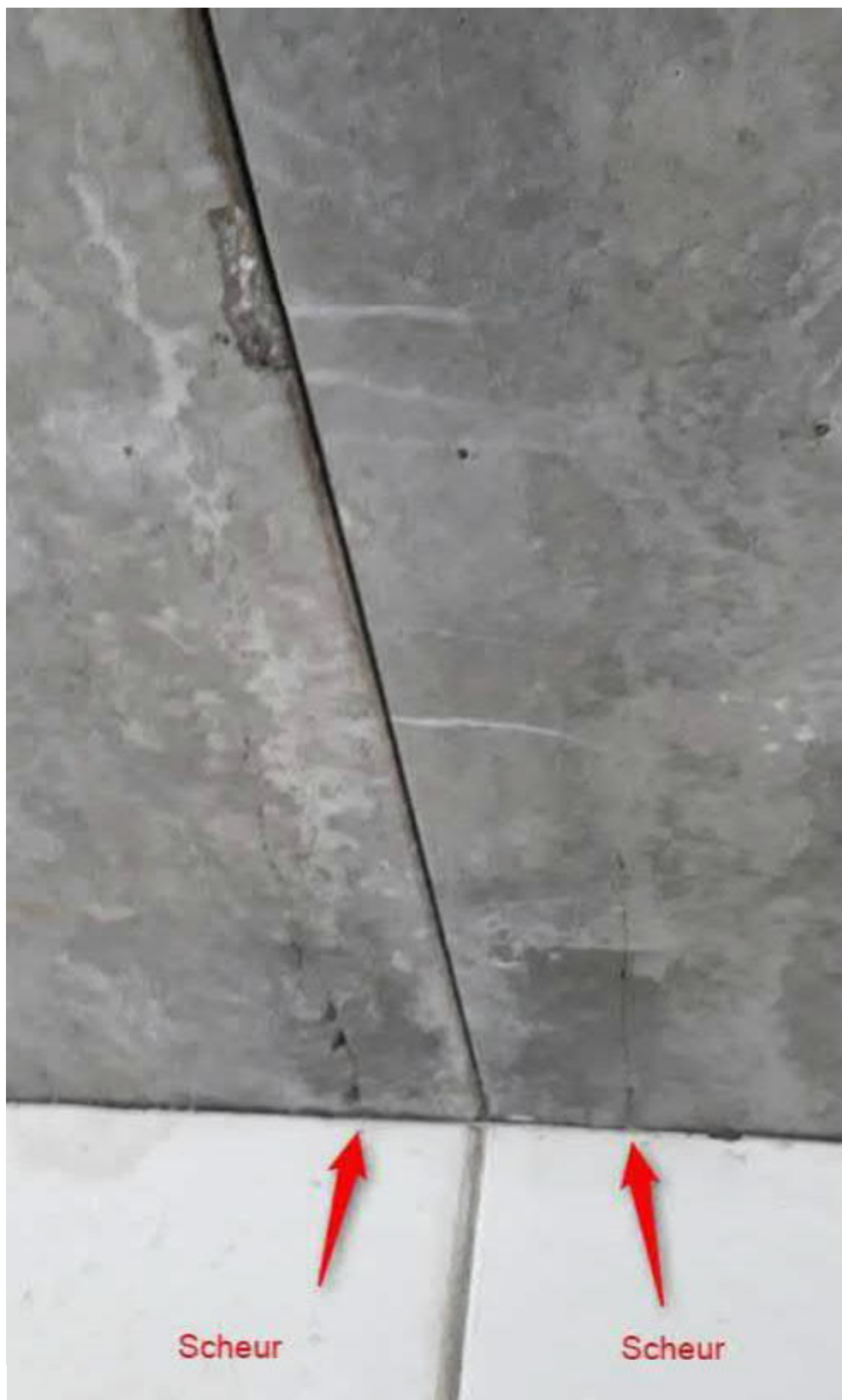
Figuur 12: Scheur in kanaalplaat t.p.v. buitenste kanaal
