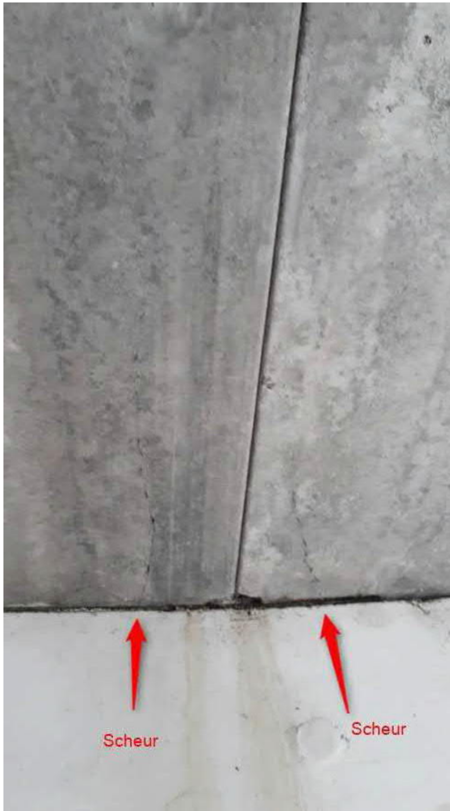
Figuur 11: Scheur in kanaalplaat t.p.v. buitenste kanaal
