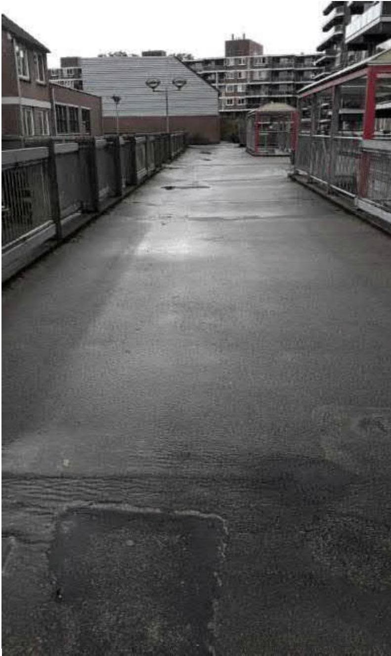
Figuur 6: Bovenop de kanaalplaten zijn inmiddels meerdere lagen gietasfalt aangebracht. Plasvorming treedt op en lekkage vindt plaats bij voornamelijk de steunpunten
