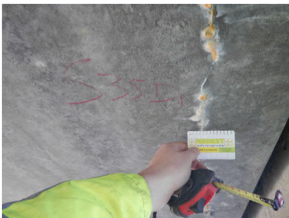
Figuur 5: Langsscheur ter plaatse van S35D
