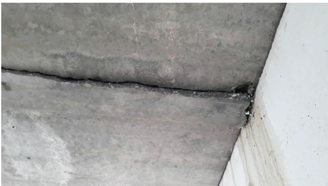
Figuur 1: Grote schade, loshangende deel van kanaalplaat
