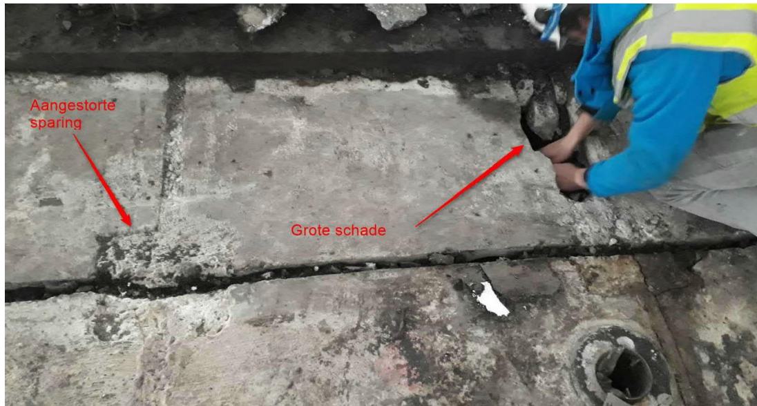
Figuur 16: Grote schade + aangestorte sparing
