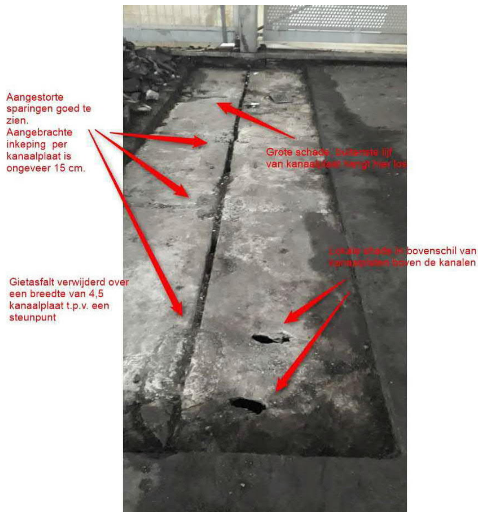
Figuur 14: Grootste onderzoeksvak met 1 grote schade en 2 lokale schades
