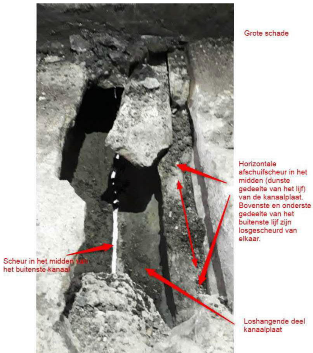
Figuur 17: Grote schade met afschuifschuur
