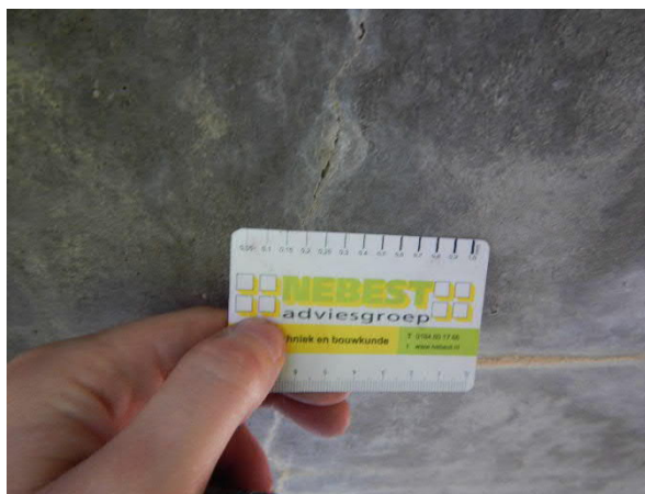
Figuur 10: Langsscheur ter plaatse van E22H
