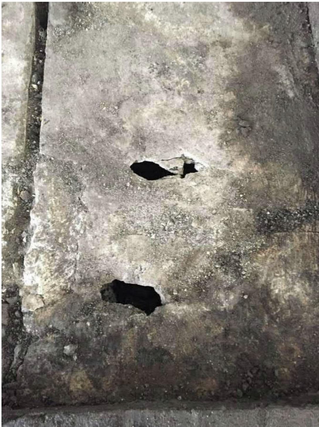
Figuur 15: 2 lokale schades in bovenshil van kanaalplaat boven de buitenste kanalen (kelkvoeg en aangestorte sparing goed te zien)
