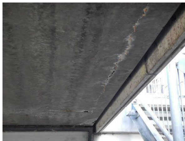
Figuur 6: Langsscheur ter plaatse van S35D
