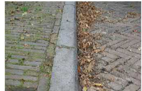
Afbeelding 5.2.9: klinkers in het trottoir
