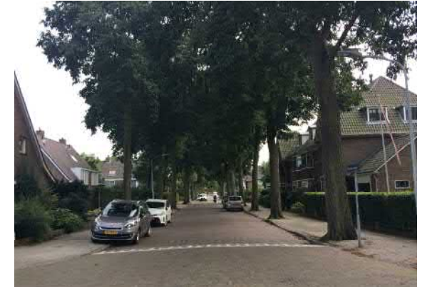
Afbeelding 5.2.5: Prins Mauritslaan, asfalt op trottoirs
