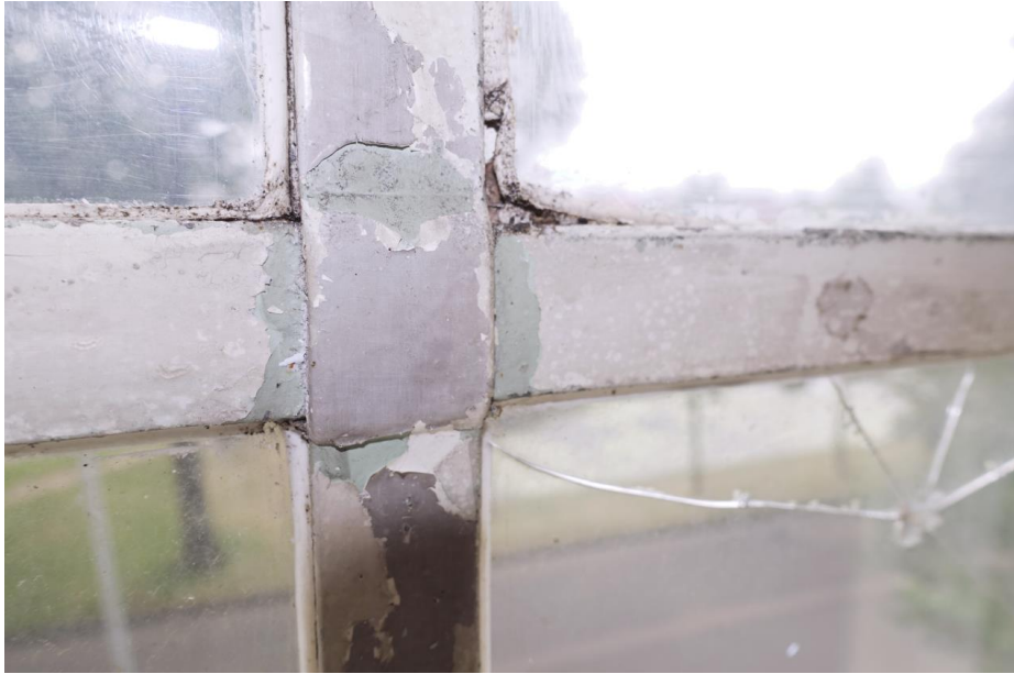
Detail van de kruising van de stalen roede bij een van de vensters in de voorgevel. Er zijn meerdere verflagen aanwezig op de roeden.
