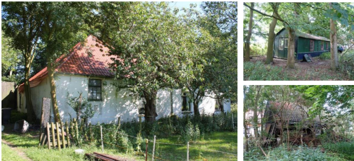
Afbeelding 2.2.: foto's boerderij (links, dak inmiddels ingestort) en knechtswoning, volkstuinkeet (rechtsboven) en koetsschuur (rechtsonder).
