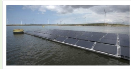
Drijvende zonnepanelen- Arnhem
