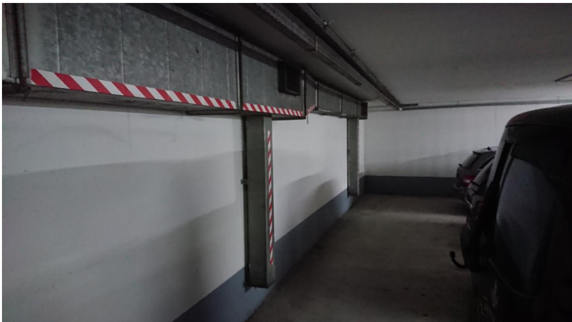
Afbeelding 5.3 Ventilatiekanalen (aan voorzijde)
