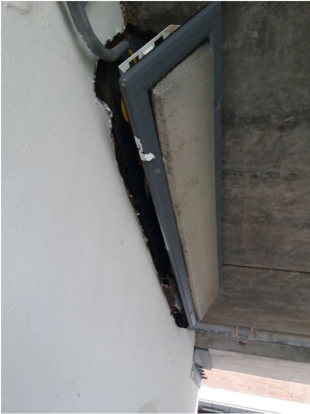
15 Sandenburg Open(weggerot) lichtarmatuur onder voetgangersniveau 20200822_123557_resized
