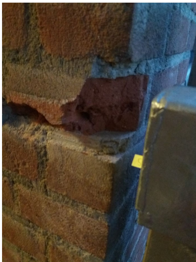
14 Portiek 184-192 beschadigde muur 20200901_204217_resized
