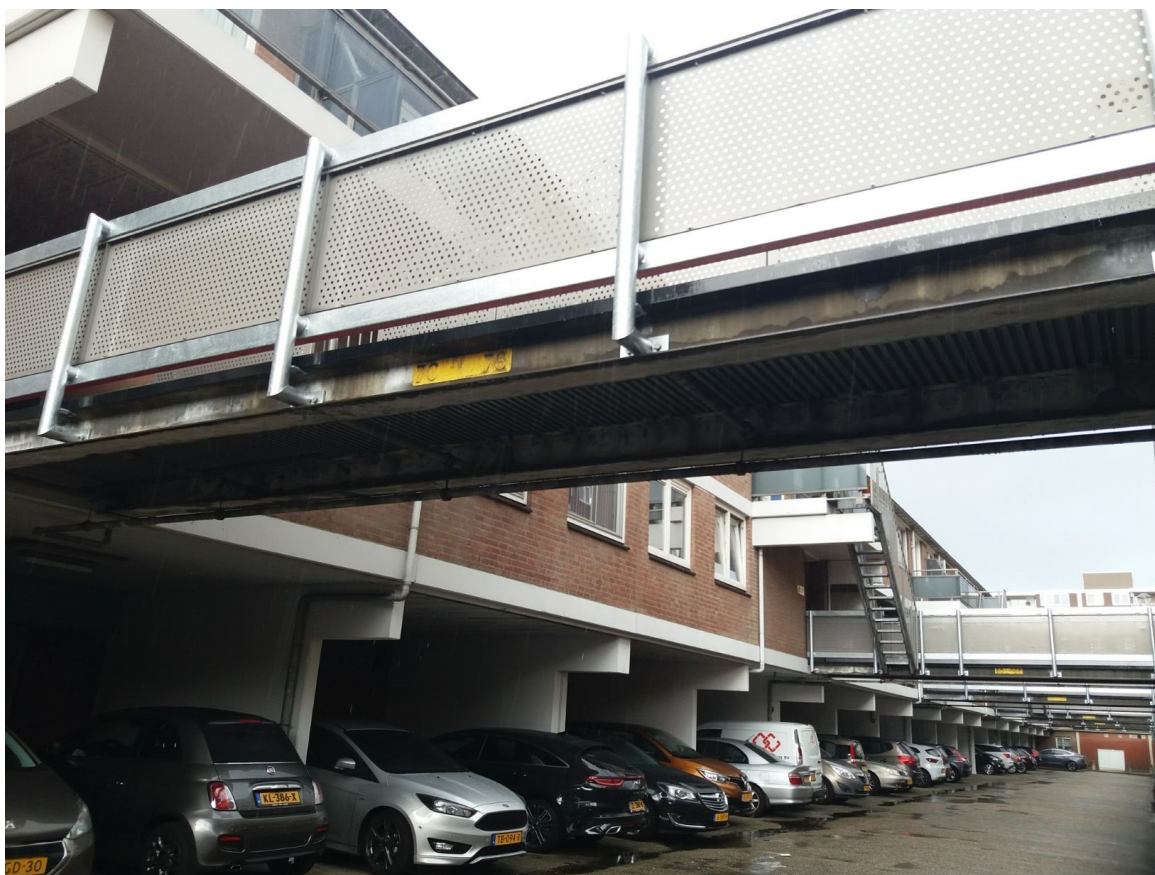
11 Sandenburg Onderzijde loopbrug niet schoongespoten en liggers niet geschilderd 20200822_123736_resized
