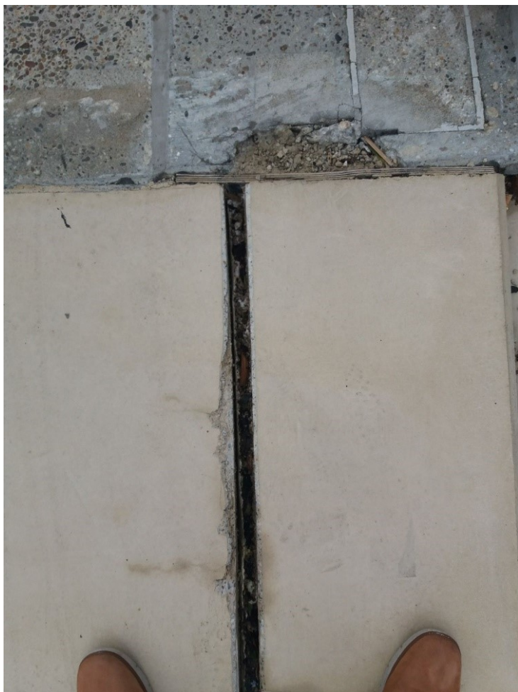
09 Sandenburg nr's 4 tot 12 uitzetvoeg in opgang loopbrug naar gebouw 20200827_112718_resized_1
