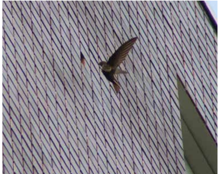
Gierzwaluwsteen weggewerkt in gevel
