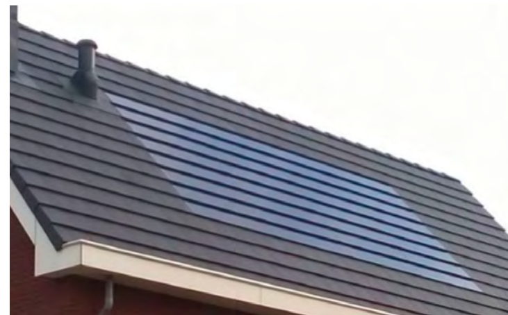
zonnepanelen geïntegreerd in het dak
