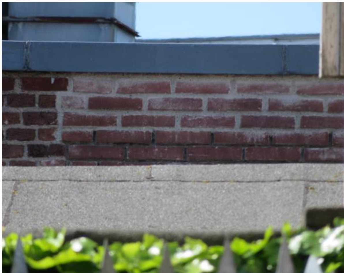
Geen open stootvoegen in het metselwerk.
