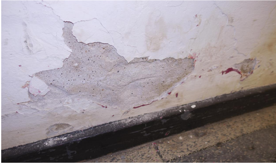
De noordgevel heeft aan de binnenzijde nog de oude verflagen achter het huidige pleisterwerk.
