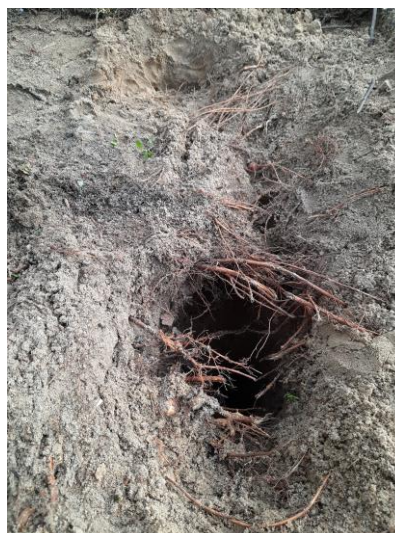
Afbeelding 14. Beworteling direct onder tegelverharding
