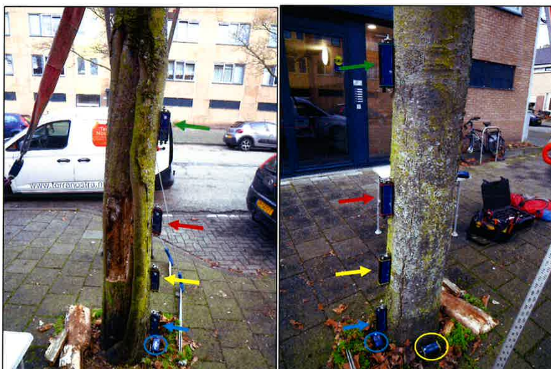
Foto 53 en 54: Links en rechts een beeld van de sensorplaatsing en de bastafsterving met inrotting. De inclinometers zijn met cirkels en de elastometers met pijlen aangeduid. De kleur correspondeert met de kleurcodering in tabel 38.
