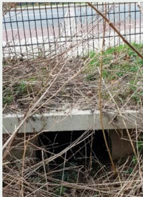
| Amfibieëntunnel onder Engelandlaan
