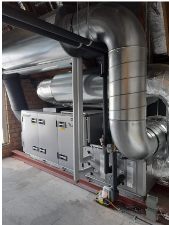
Nieuwe luchtbehandelingsinstallatie Rijksmonument
