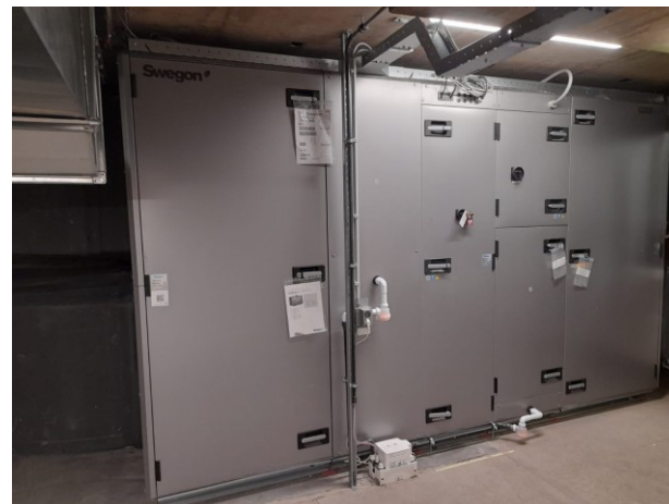
Nieuwe luchtbehandelingsinstallatie Nieuwbouw
