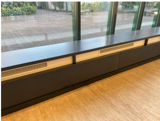
Nieuwe banken met geïntegreerde luchtbehandelingsinstallatie Nieuwbouw
