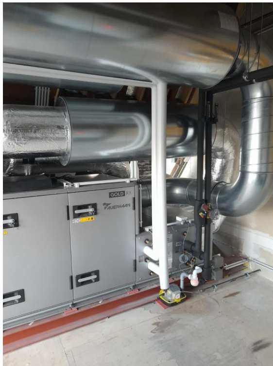
Nieuwe luchtbehandelingsinstallatie Rijksmonument
