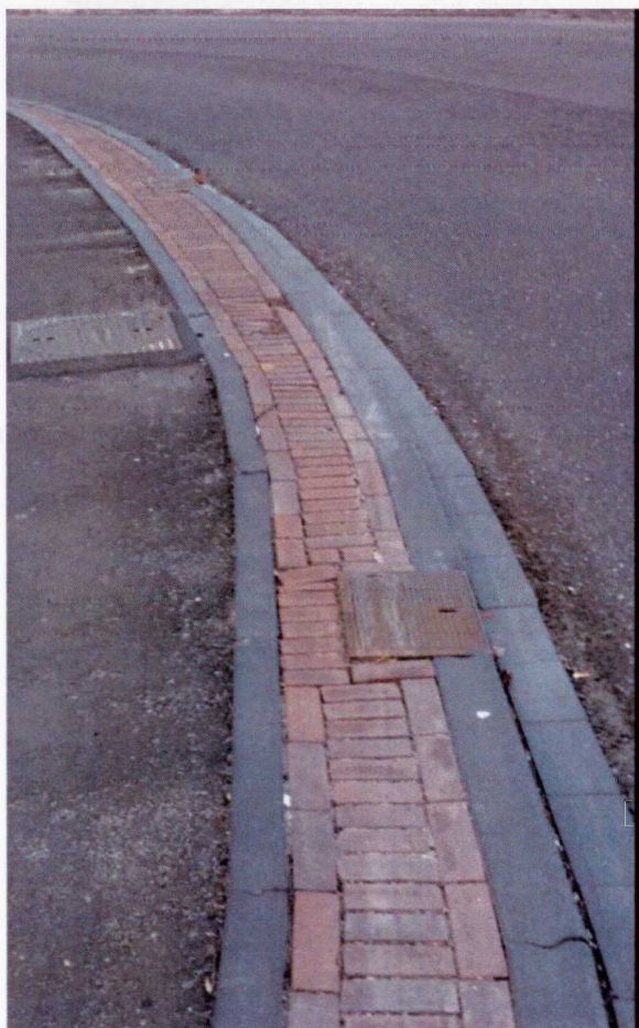
Foto 2 bandensporen op troittoirband/fietspad en beschadigingen door bussen
