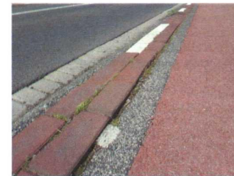
afbeelding 21 "Tussenstrook" van klinkers ligt niet egaal
