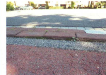
afbeelding 22 "Tussenstrook" van klinkers ligt niet egaal
